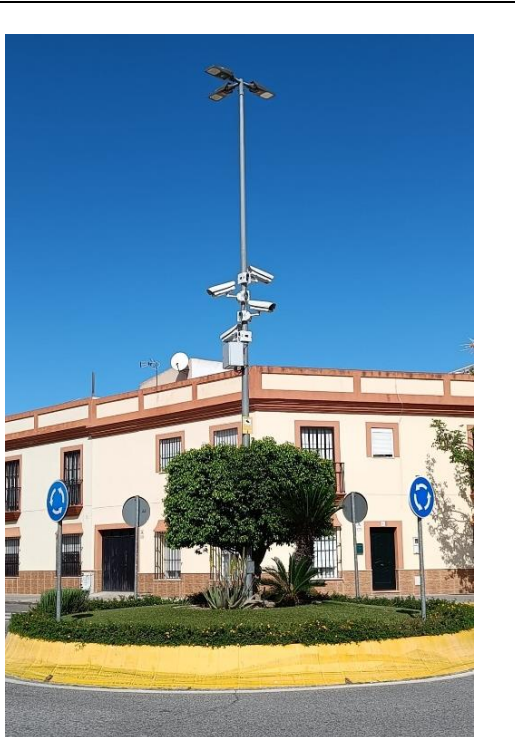
EMPLAZAMIENTO 9.1: TRAS LA INSTALACIÓN
