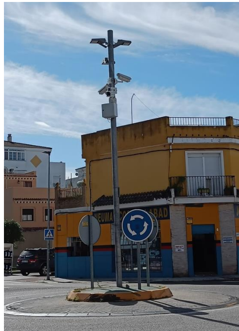
EMPLAZAMIENTO 8.1: TRAS LA INSTALACIÓN
