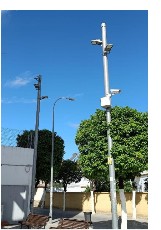
EMPLAZAMIENTO 10.1: TRAS LA INSTALACIÓN
