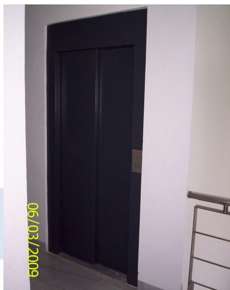
Vista diagonal derecha del ascensor con puertas automáticas.
