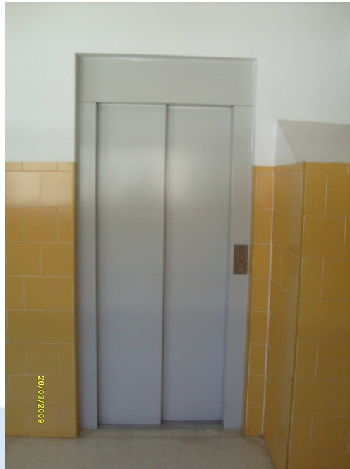
Ascensor automático con puertas metálicas de doble hoja.
