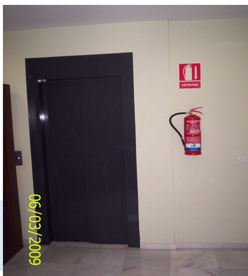
Vista frontal del ascensor con puertas automáticas abatibles.
