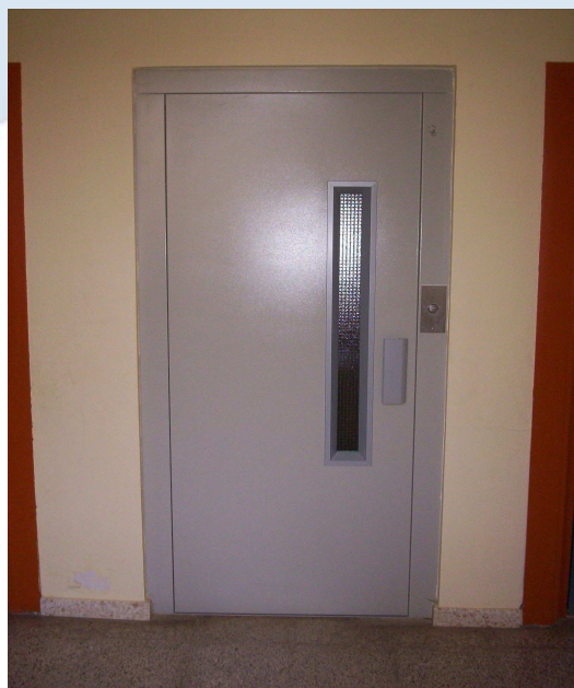
Vista frontal del ascensor con puerta metálica.
