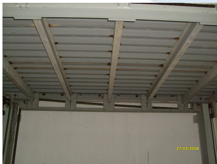
Estructura metálica de la plataforma elevadora del montacargas.
