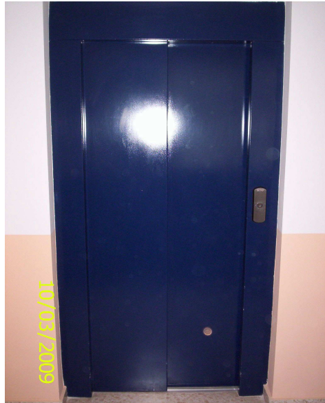
Vista frontal del ascensor con puertas metálicas automáticas de doble hoja.
