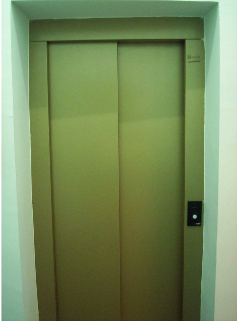
Vista frontal del ascensor OTIS, con puerta cerrada y abierta con iluminación interior.
