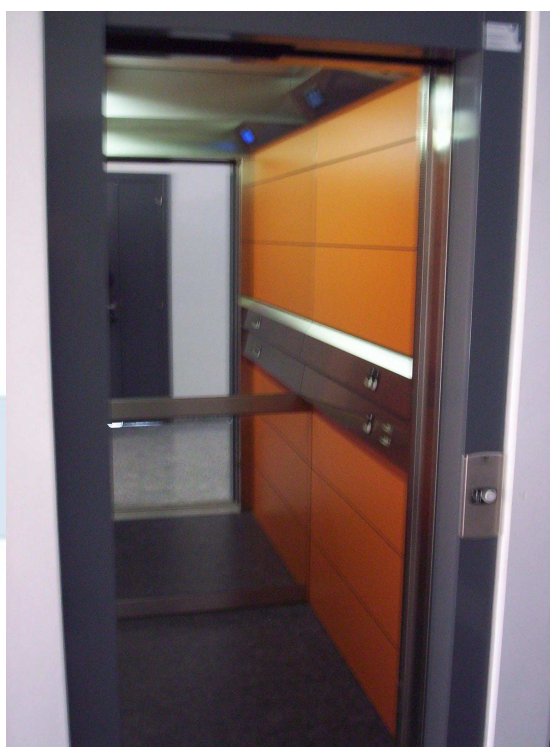
Vista frontal del ascensor automático, con puertas metálicas de doble hoja.
