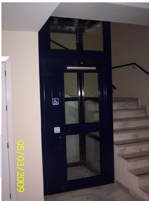
Vista frontal del ascensor en planta baja.
