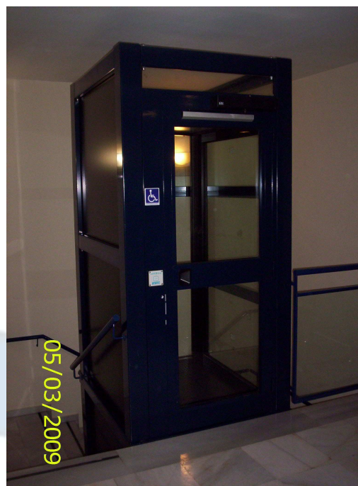
Vista frontal del ascensor en planta alta.
