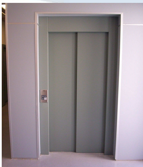
Ascensor eléctrico automático con puertas metálicas de doble hoja.
